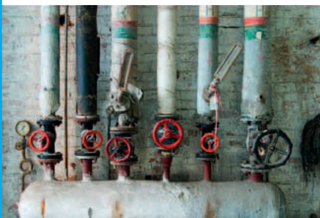
Dettaglio di tubazioni e valvole di un impianto di distribuzione idrica
